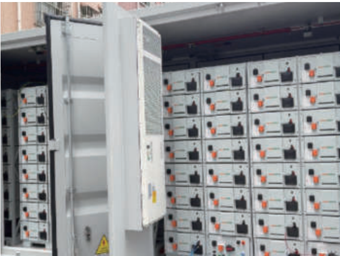
▼ 2.15MWh/ 1MW PCS (Megarevo)
