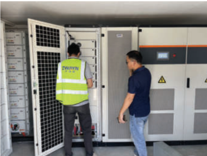
▼ 2.15MWh/ 500kW PCS (Megarevo)/PV 500kW
